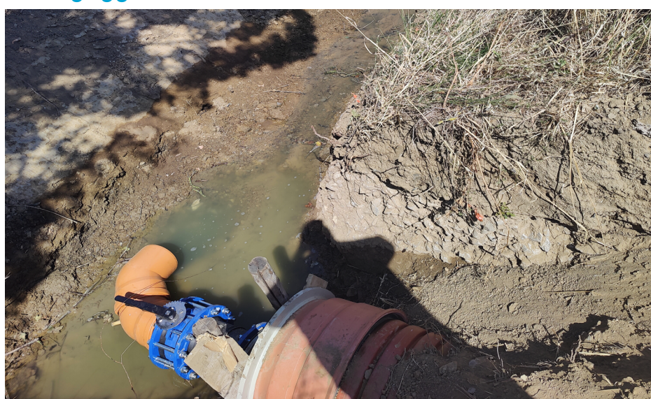
Uno dei punti di uscita delle acque filtrate che ritornano al lago
